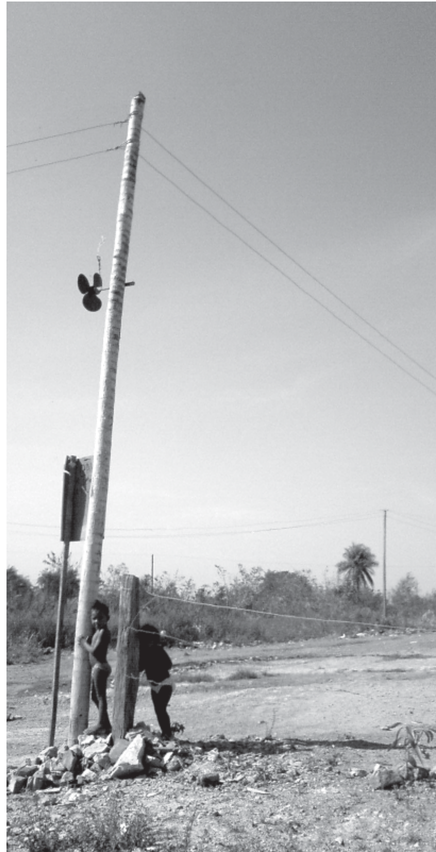
Figura 197 – Eletrificação irregular, Alto Bonito
