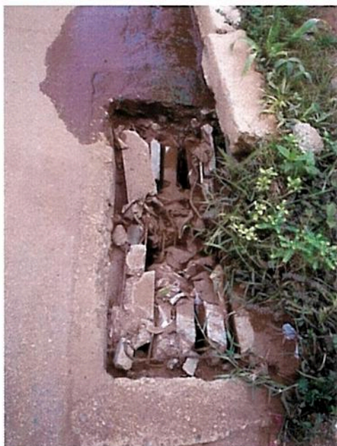
Figura 7.2 – Bueiro com entulhos
