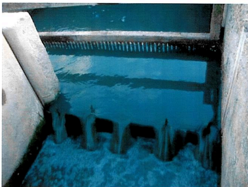
Figura 10.9 - Unidade de tratamento biológico do SES de Canaã dos Carajás (PA)- Unidade de gradeamento.
