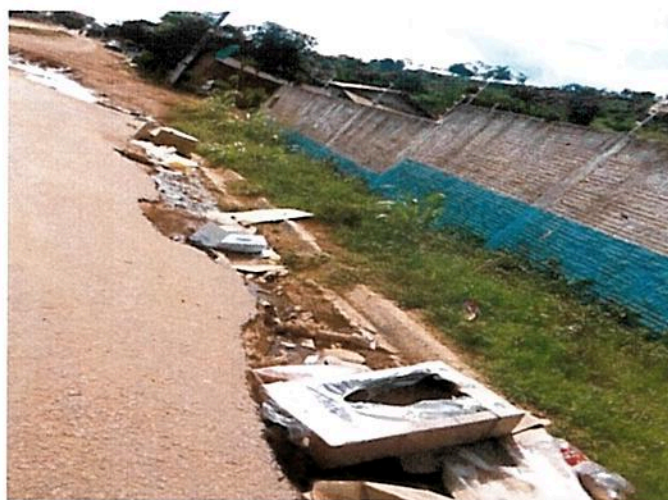
Figura 8.4 - Limpeza urbana inadequada, comprometendo o sistema de drenagem
