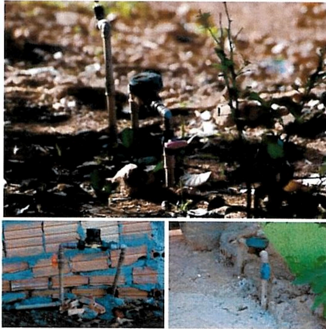
Figura 5.8 – Ligações domiciliares com micromedidores.
